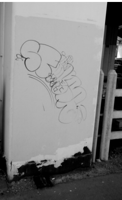
JR高架下のはしらは。巻いた鉄板の下の方にさびが出ている
